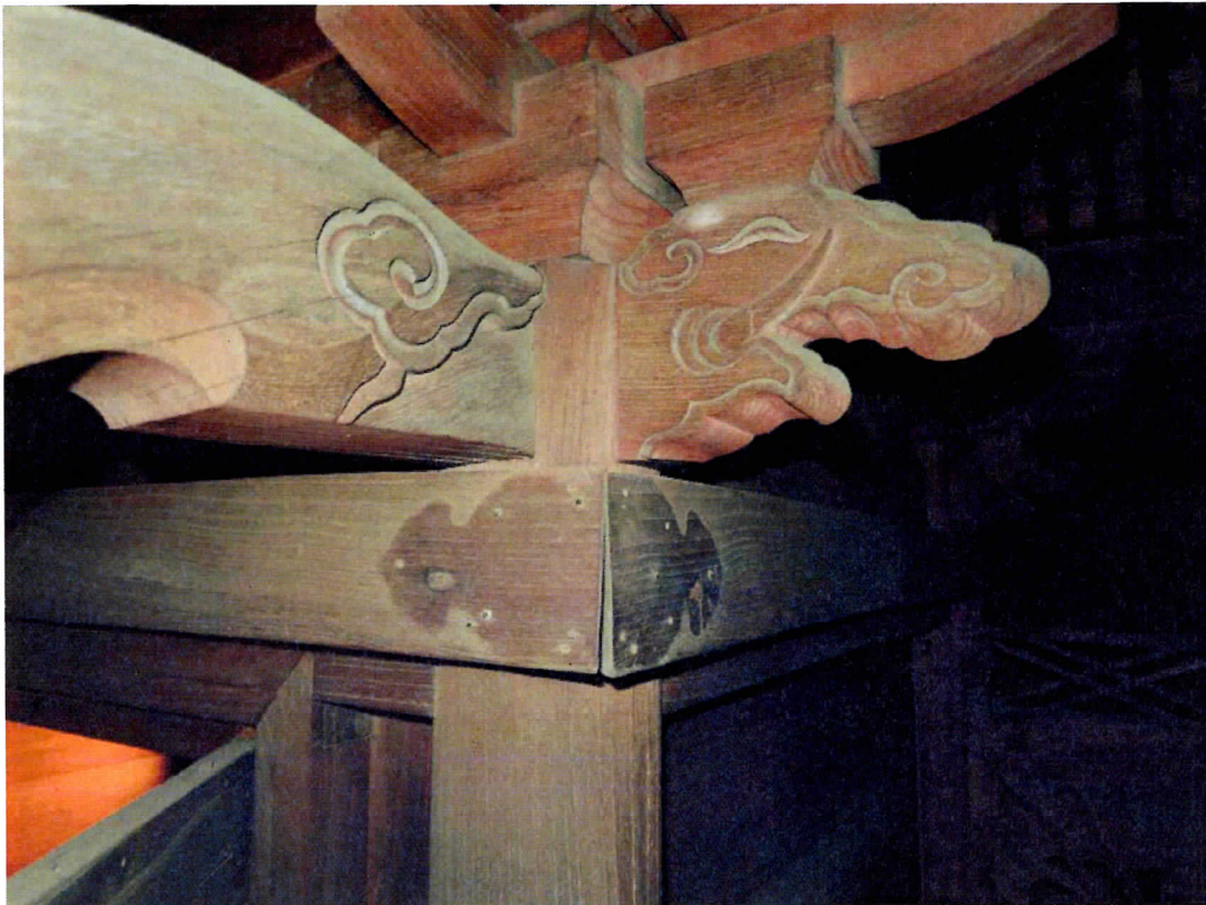
1 2. 日枝神社本殿 身舎正面木鼻・内法長押 正面桁行の木鼻は象鼻形状で、頂部に巻斗をのせて連三斗組物を構成する。柱頂や木鼻・組物は赤味がかっており、内法長押隅の八双金具欠失部分も同様に、本来は拭き漆仕上げされていたようである。
