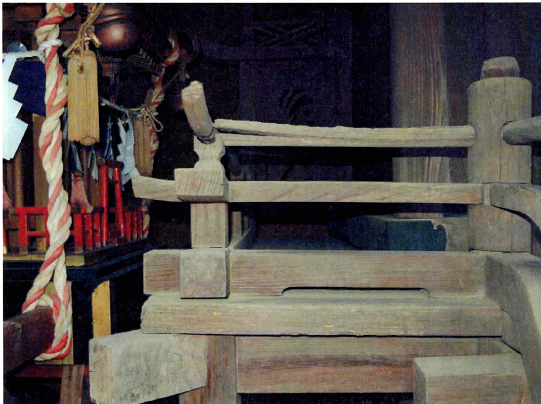
7. 日枝神社本殿 縁高欄 高欄は跳高欄(ハネコウラン)形式で一部破損が認められる。
